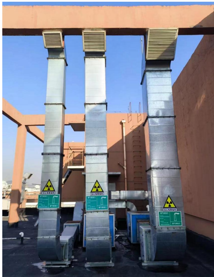
图4-32 放射性废气排放系统
